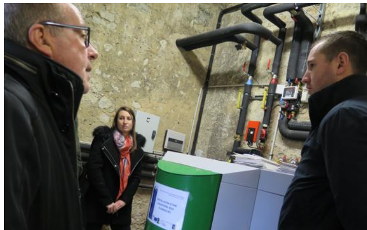
La chaufferie bois à granulés fonctionne pour l'ensemble du bâtiment réhabilité, avec des compteurs indépendants.
